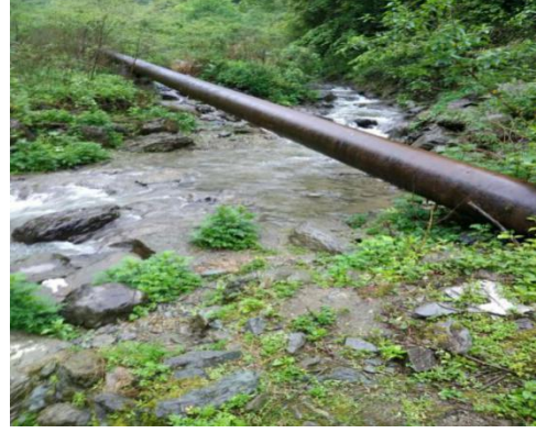
马金子电站压力管道周围生态恢复现状
