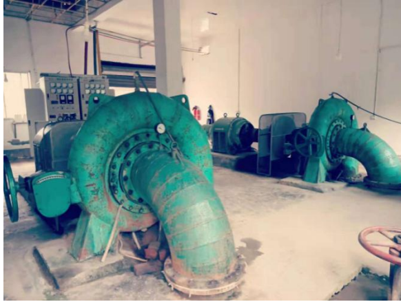
跳脚石三级电站厂房
